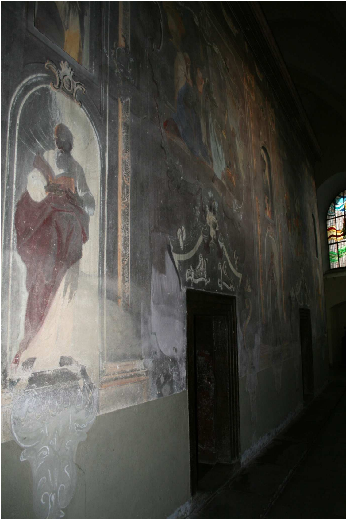
Fot.1. Ściana wschodnia. Stan przed konserwacją.
