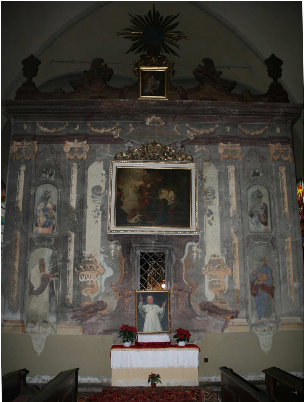
Fot.5. Ściana frontowa. Stan przed konserwacją.
