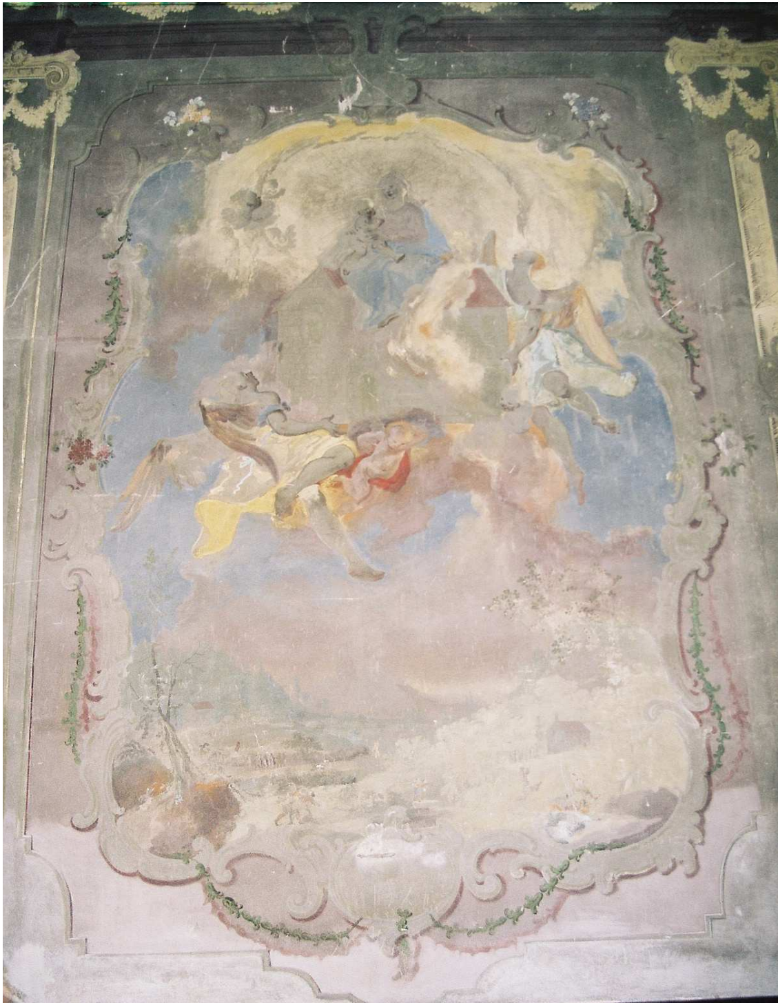
Fot.1. Ściana północna. Stan przed konserwacją.
